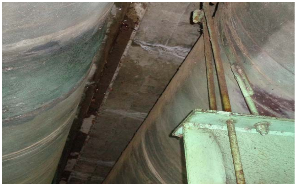
바닥판하면 캔틸레버 균열부백태 (S4)
