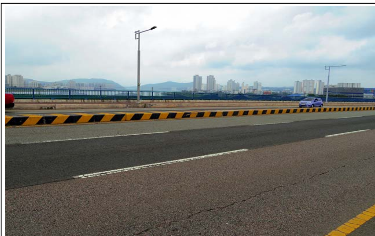
교면포장 아스콘 균열(S4)
