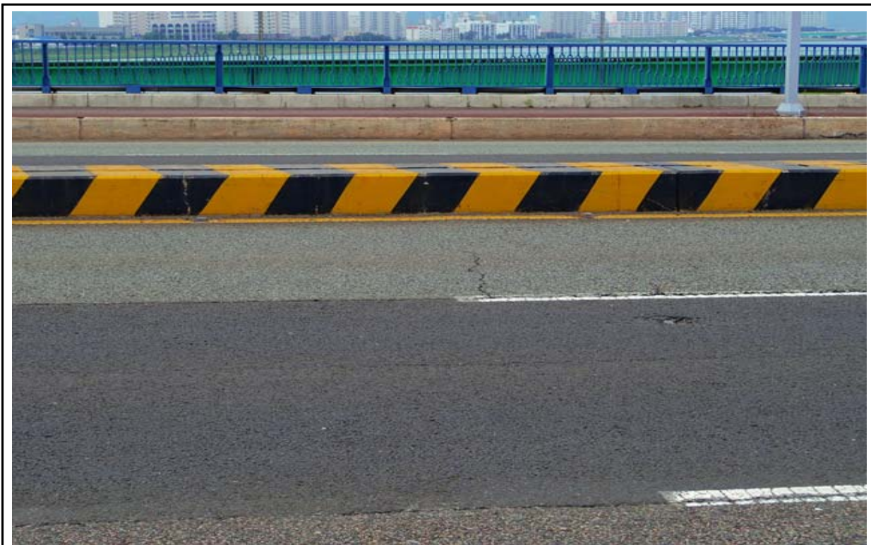
교면포장 아스콘 균열(S1)
