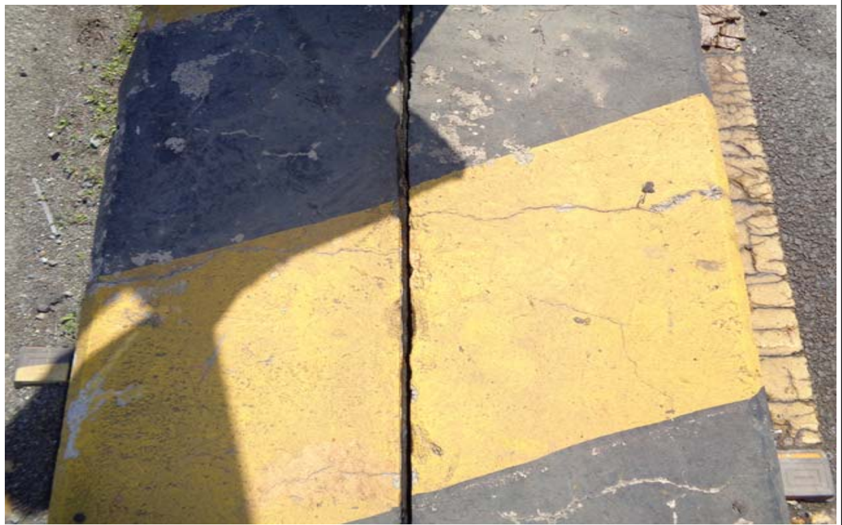
중분대 균열 (S9)
