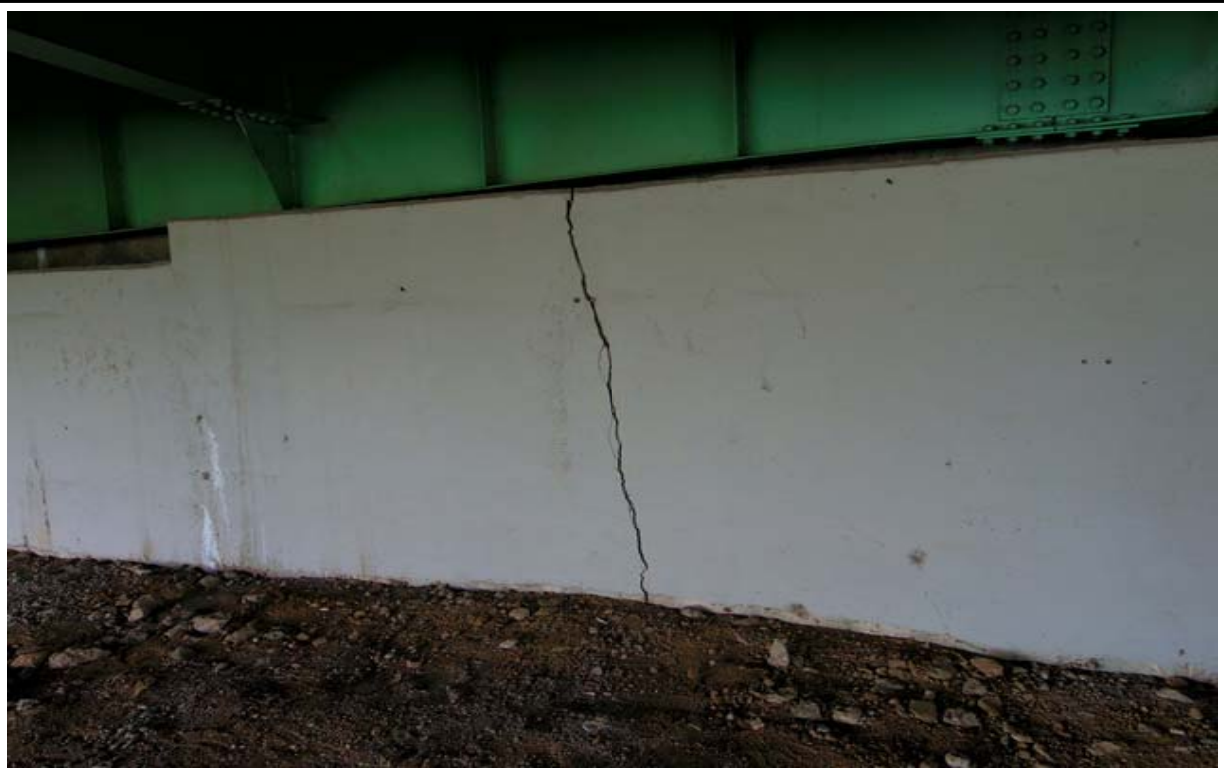
교대 균열 (A2)
