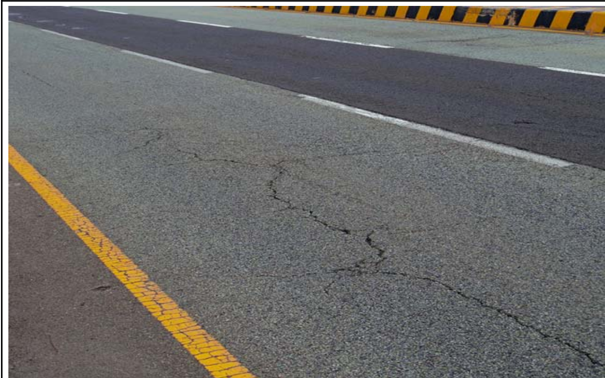
교면포장 아스콘 균열(S8)
