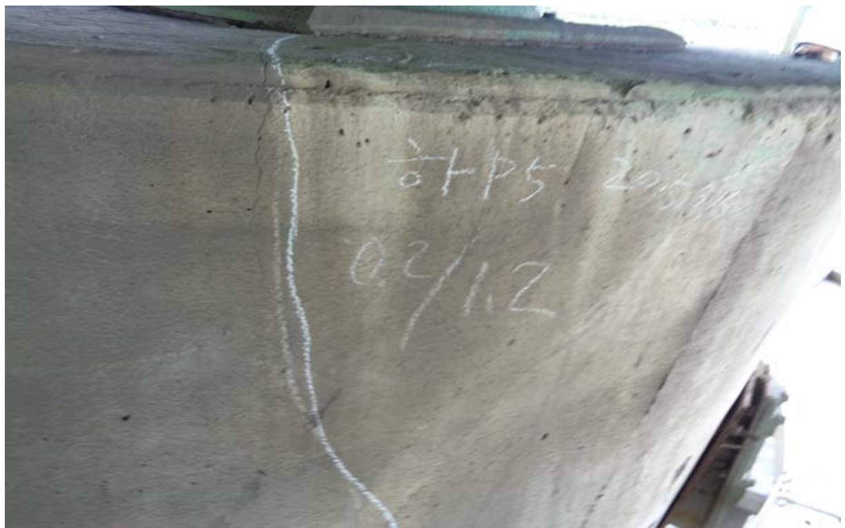
교각 기둥부 균열 (P5)
