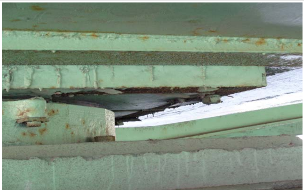
교량받침 부식 (P2-SH2)
