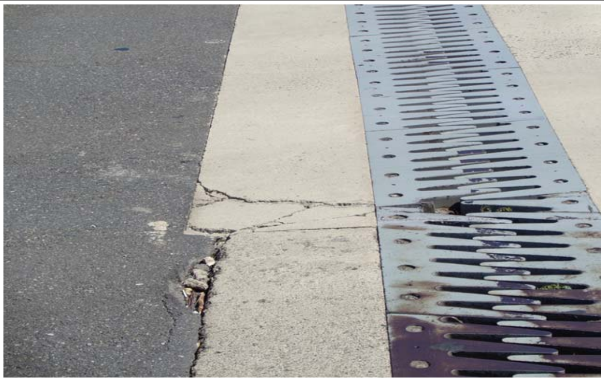
신축이음 Exp1(A1) 후타재 균열
