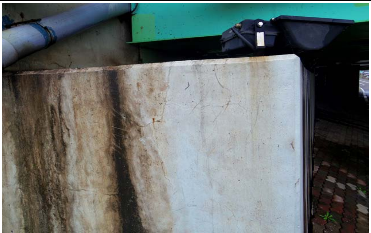
교대 망상균열 (A1)
