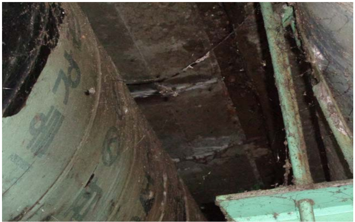
바닥판하면 캔틸레버 균열부백태 (S3)
