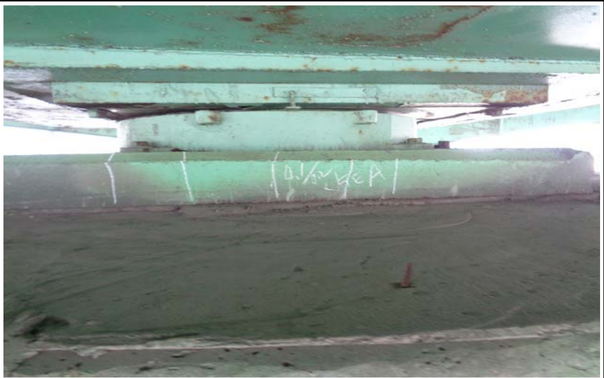
교량받침 몰탈균열 (P3-SH3)
