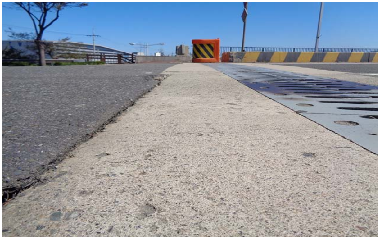
신축이음 Exp1(A1) 후타재 균열
