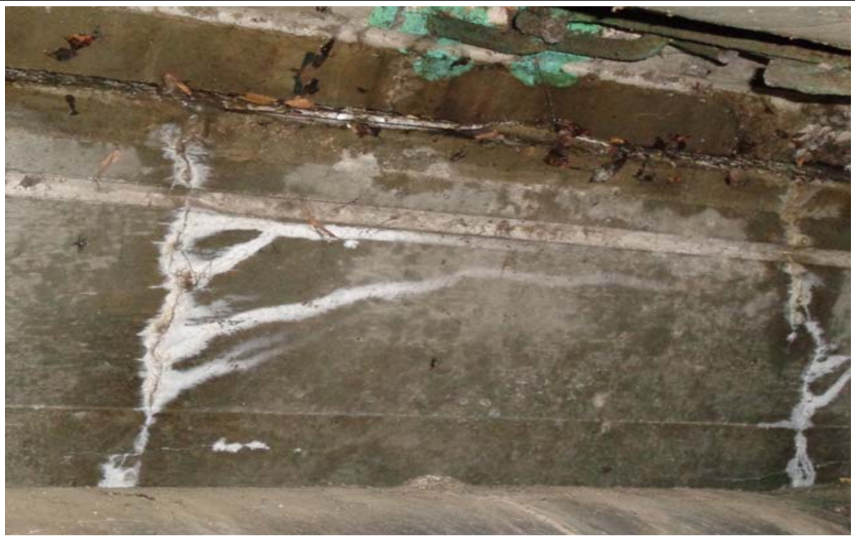
바닥판하면 캔틸레버 균열부백태 (S9)
